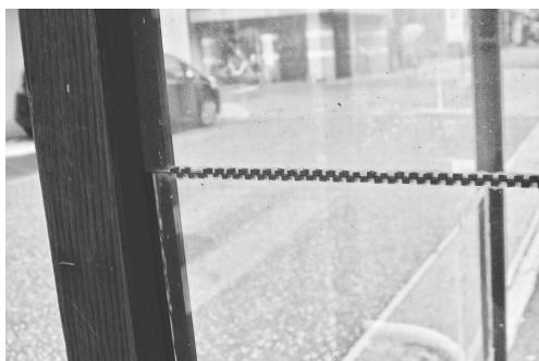
この継手のある側面は雨の当たらない店舗側の軒下
