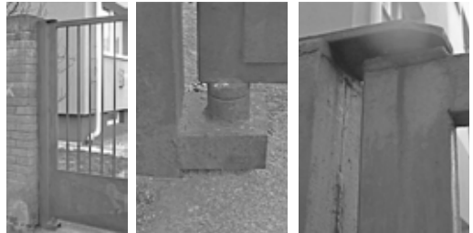
ブラハのアパートの門で、枠と丁番、建具が一体でつくられている。錆びているが現役
